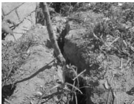
Figura 10. Grieta con una profundidad de más de 6 metros. Ubicada en la Asunción..
