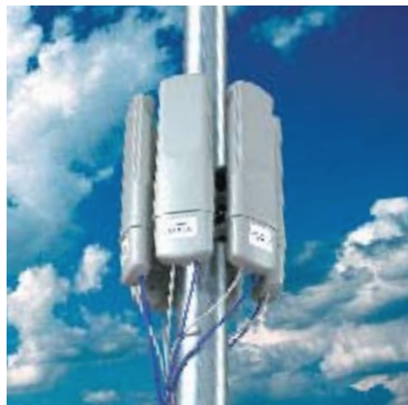
Emplazamiento de Punto de Acceso (AP)
